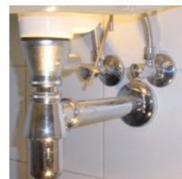
Eckventile unter dem Waschbecken mit Sifon
